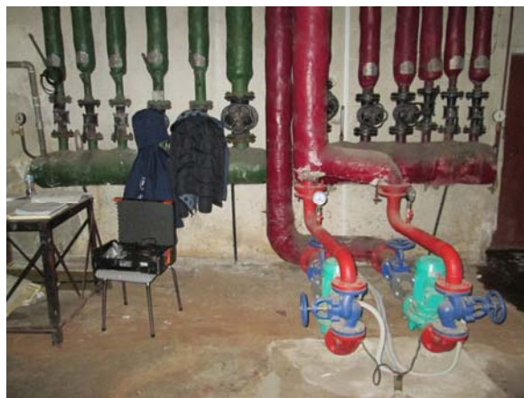
Разпределителен колектор и циркуляционни помпи за отопление
